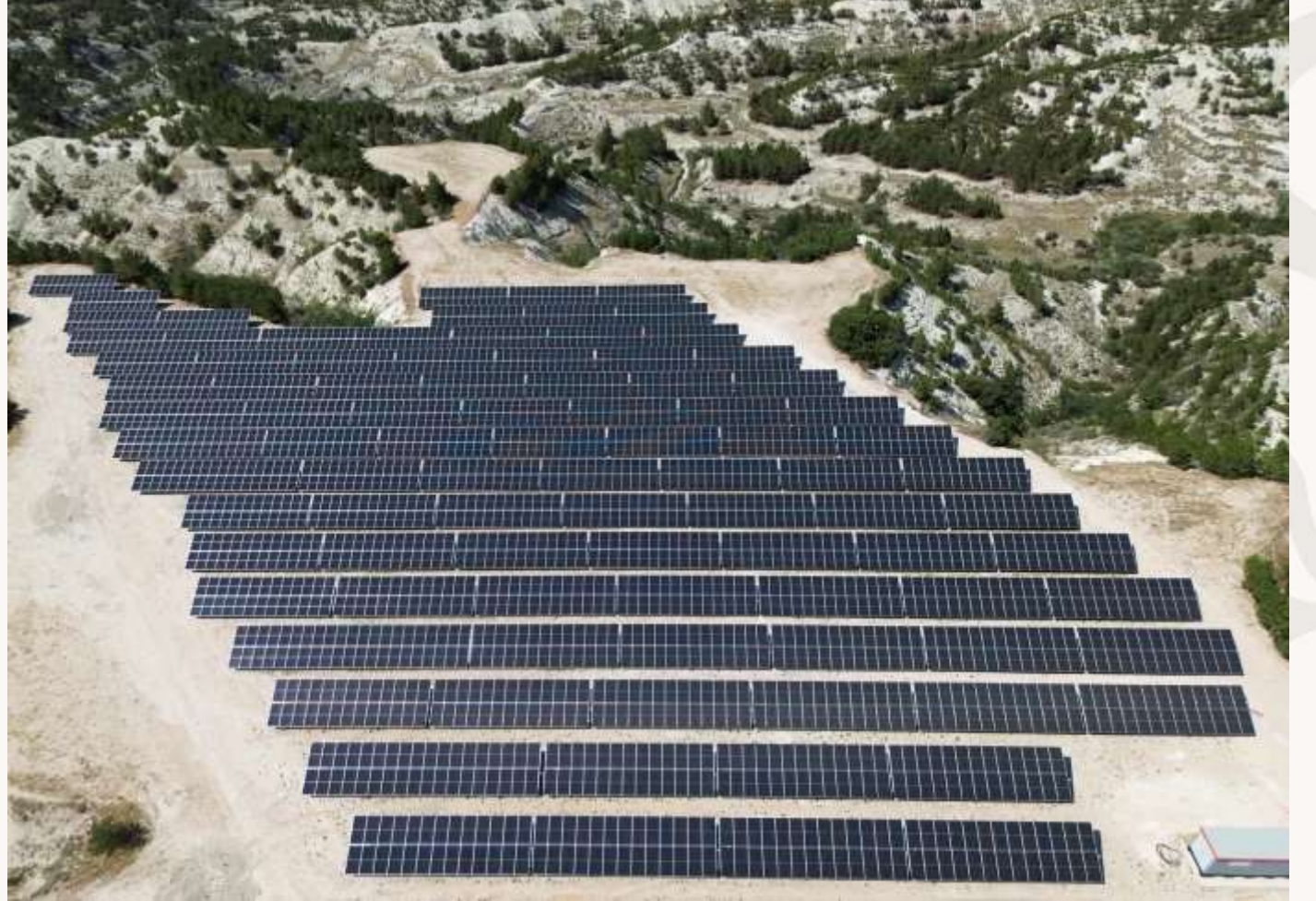
BURDUR – YASSIGÜME 4.2 Mwh
